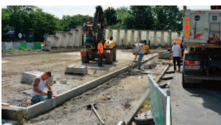
Création de places de parking rue Amelin (quartier de la Comète) réservées aux riverains en prévision des travaux de la rue Prévoyance.
